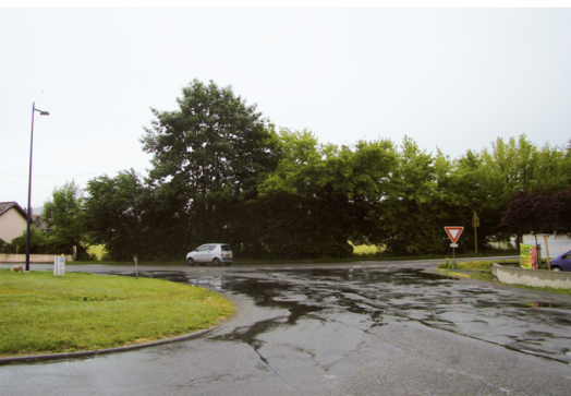
Dans quelques semaines, un rond point va voir le jour avenue du Nord
